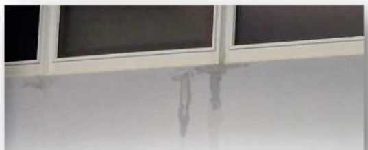
An den Undichtigkeiten am Fensterband Ist der Förderverein TuS Gümmer dran.
